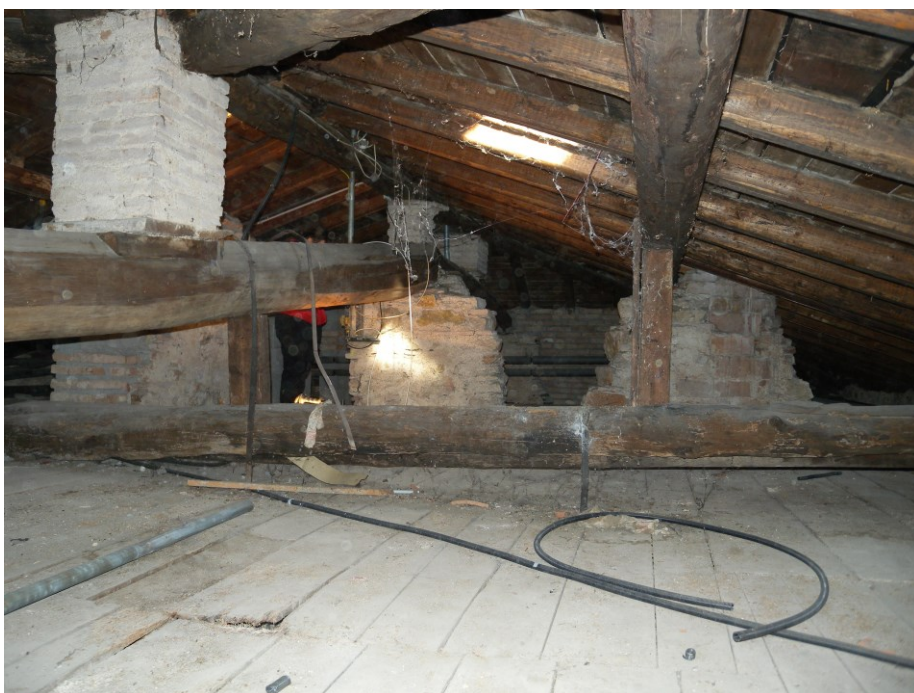
Figura 3 Trave di colmo prima dell'intervento
